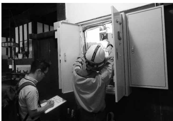
▲大主殿での電気設備点検の様子
